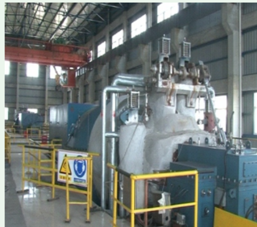
承建的长钢余热发电项目达到每吨矿18KWh的先进水平
