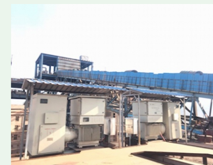
三铁烧结机头电除尘提效改造
